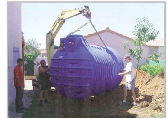
Ci-dessus : Cuve de réutilisation des eaux de toiture
