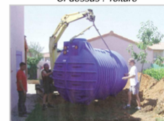
Ci-dessus : Cuve de réutilisation des eaux de toiture
